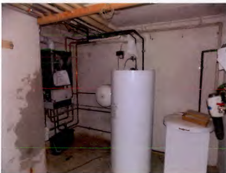
KG: Gastherme mit Warmwasserspeicher
