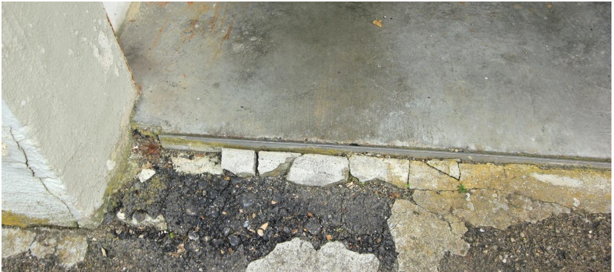
Schäden bei der Anschlagschiene
