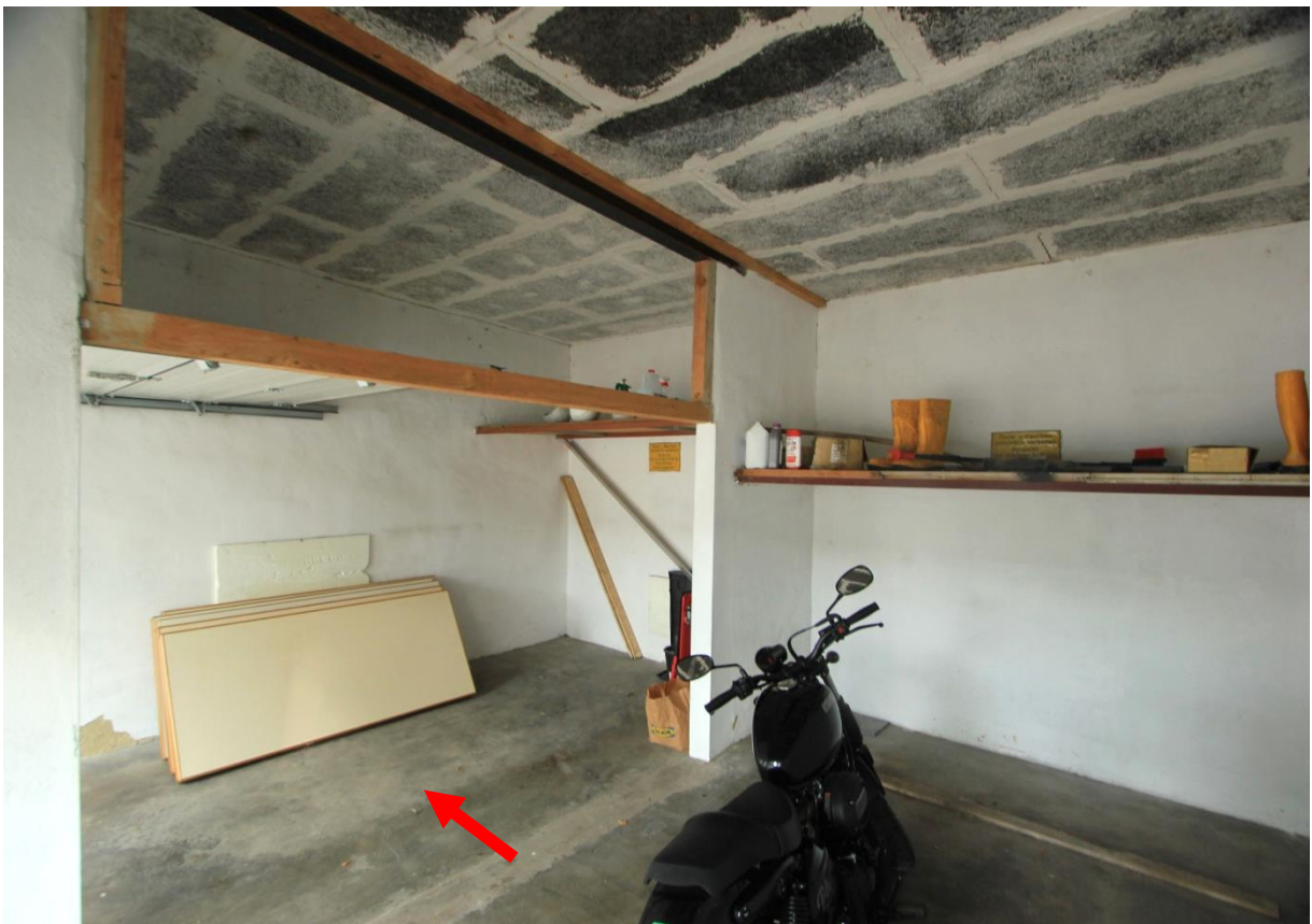
Blick von Garage ATP Nr. 5 zur Garage 6 mit Sektionaltor, fehlende Seitenwand
