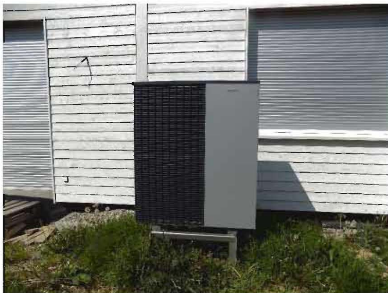
Luft-Wärmepumpe an der Südfassade
