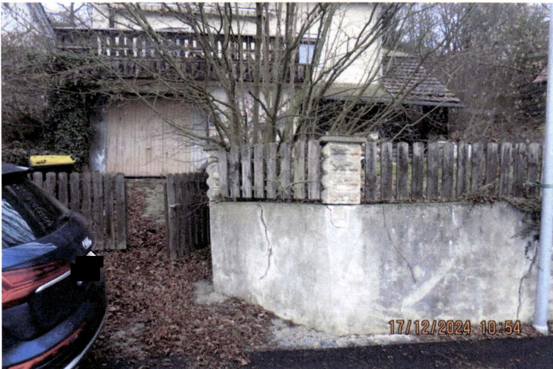
Foto 4: Schäden an der Stützmauer
