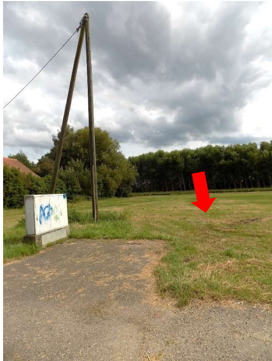
Pfeil: Flst. Nr. 762, Blickrichtung Süden, im Vordergrund: Zugang auf dem Grundstück zur Trafostation
