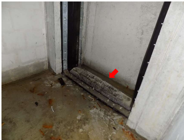
Bürohausgrundstück Flnr. 245/334, 3. Untergeschoss Bauwerksfuge zur anschließenden Tiefgarage; Pfeil: Dichtungsprofil stark aufgebläht durch hohen Grundwasserdruck
