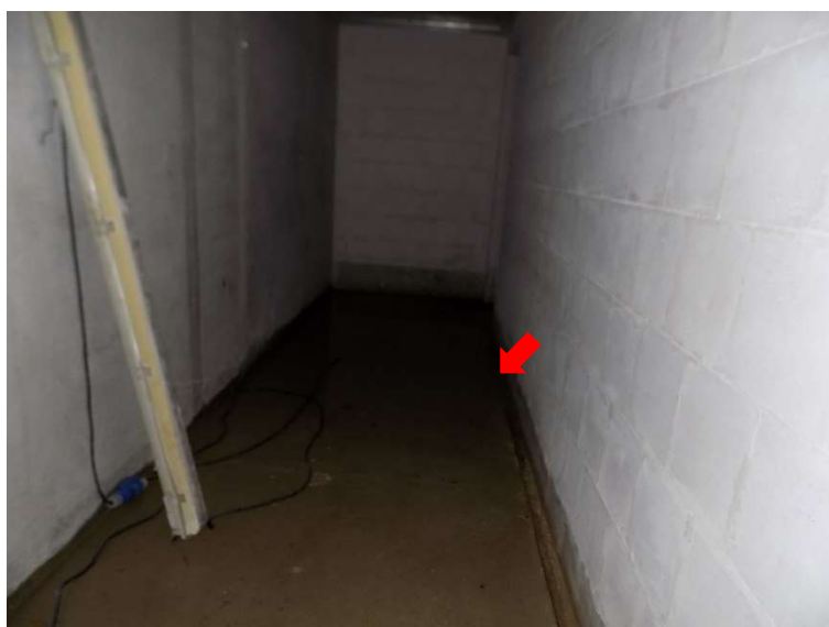
Bürohausgrundstück Flnr. 245/334, 3. Untergeschoss; vermutlich angesammeltes Regenwasser
