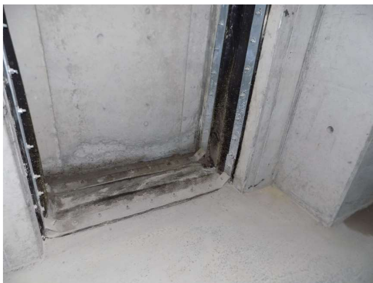
Bürohausgrundstück Flnr. 245/334, 2. Untergeschoss Bauwerksfuge zur anschließenden Tiefgarage
