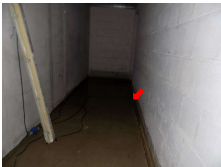
Bürohausgrundstück Flnr. 245/334, 3. Untergeschoss; vermutlich angesammeltes Regenwasser
