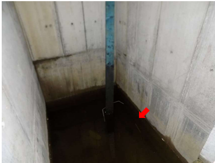
Bürohausgrundstück Flnr. 245/334, 3. Untergeschoss; vermutlich angesammeltes Regenwasser im Aufzugsschacht
