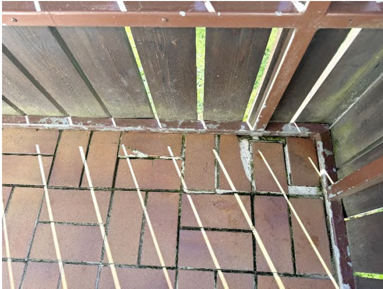
Bild 31 – Schäden an Balkonfliesen
