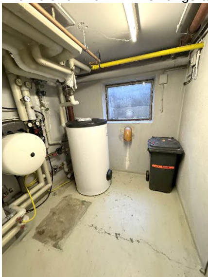
Bild 10 und Bild 11 – Heizungsraum KG
