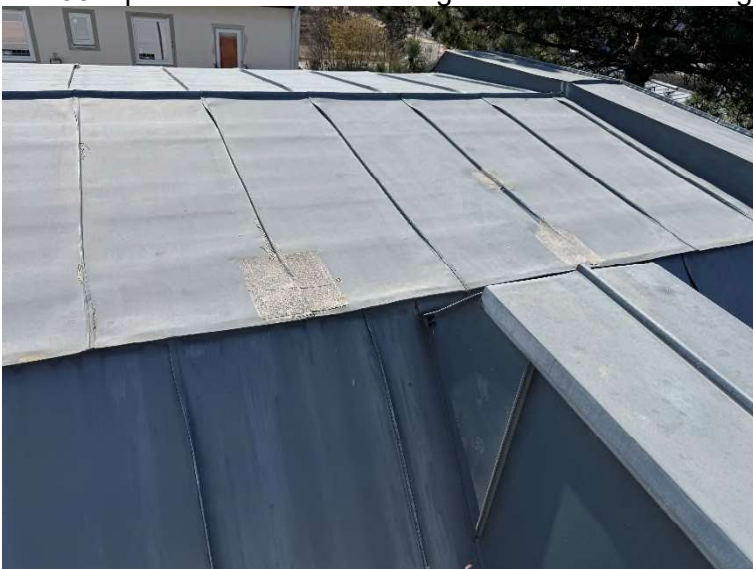
Bild 93 – provisorische Abdichtungen an Dacheindeckung
