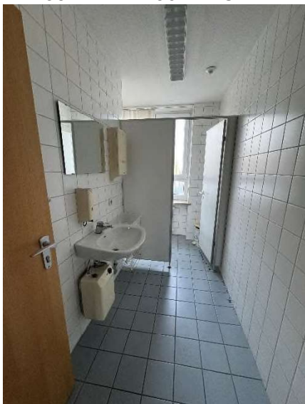
Bild 35 und Bild 36 – WC Damen EG
