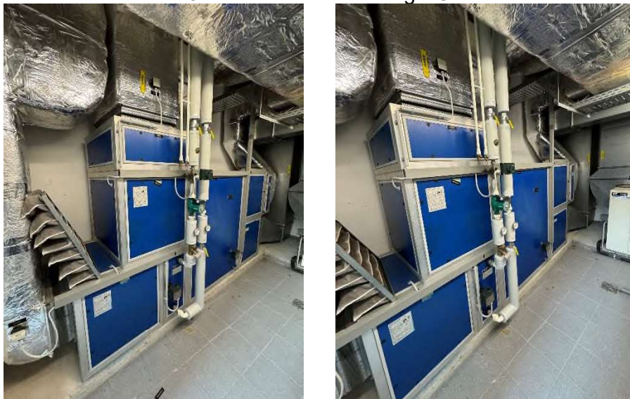
Bild 114 – Kühlaggregat im Technikraum
