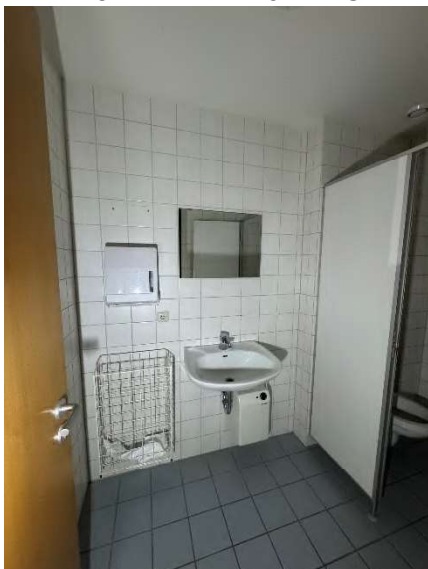
Bild 148 und Bild 149 – WC Damen 1. OG
