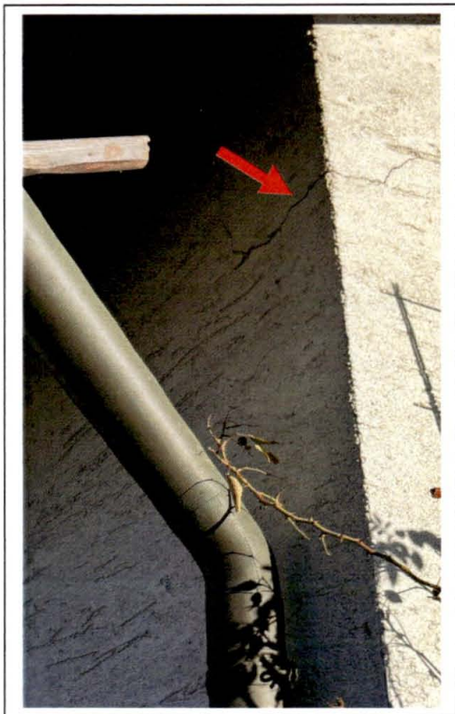
Foto 5: Risse an der Fassade
