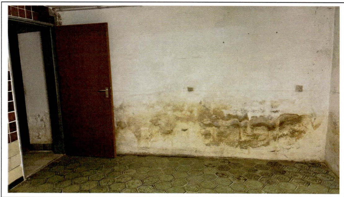
Foto 33: Feuchtigkeit an der Umfassung im Kellergeschoss
