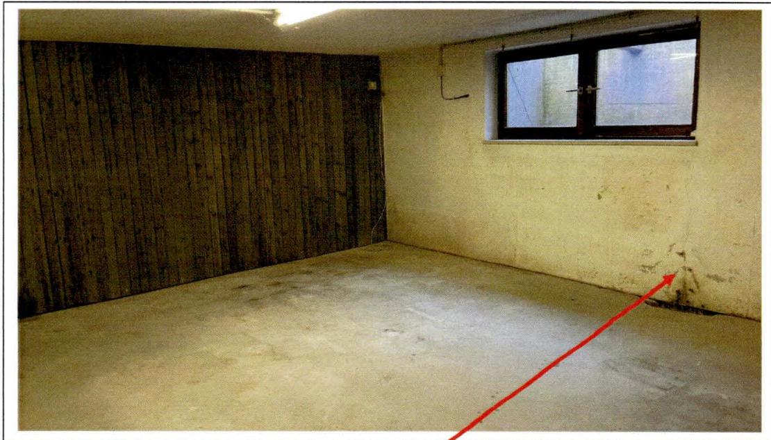
Foto 32: Blick in einen Kellerraum mit Riss an der Umfassung
