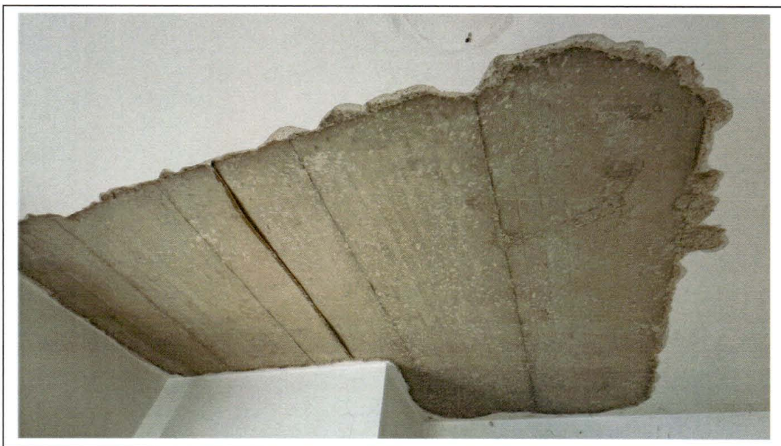
Foto 25: Decke ohne Putz im Kinderzimmer (Südostausrichtung)
