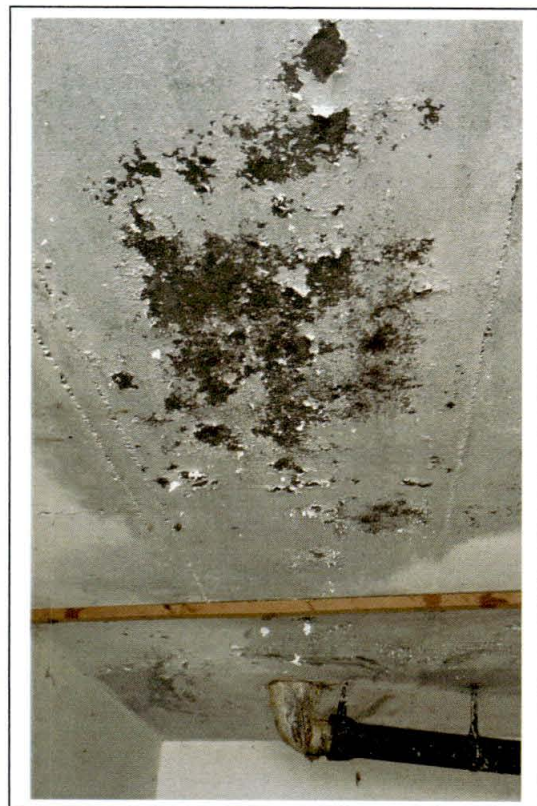
Foto 12: Feuchtigkeit an der Decke
