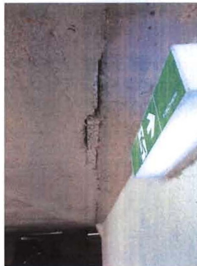
nicht fachgerechte Trennfuge
