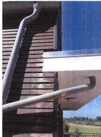
Anschlüsse Vordach nicht fachgerecht
