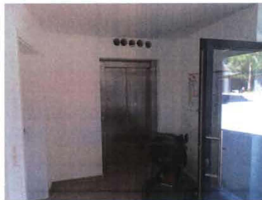
Aufzug Haus Nr. 9
