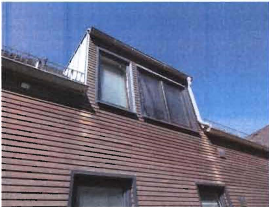
Holzfassade abgewittert, teilweise lose
