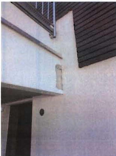
Putzschaden / Riss Fassade
