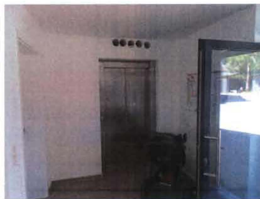
Aufzug Haus Nr. 9
