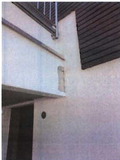
Putzschaden / Riss Fassade
