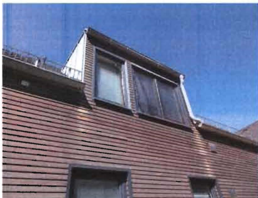
Holzfassade abgewittert, teilweise lose
