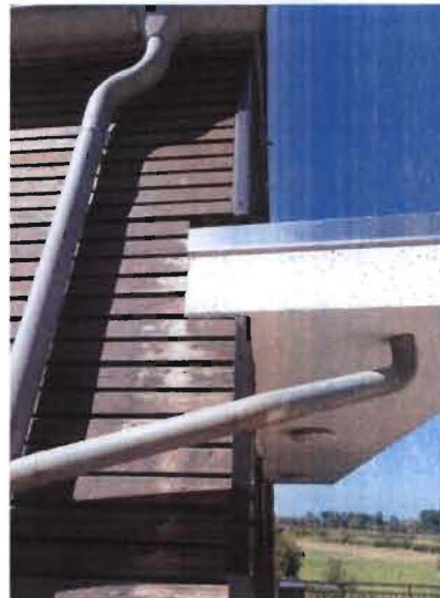
Anschlüsse Vordach nicht fachgerecht
