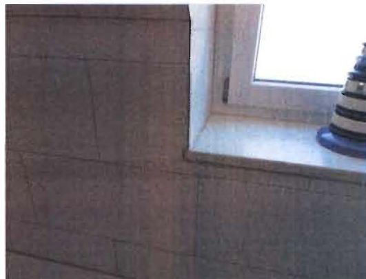
Fliesenarbeiten Bad nicht fachgerecht ausgeführt
