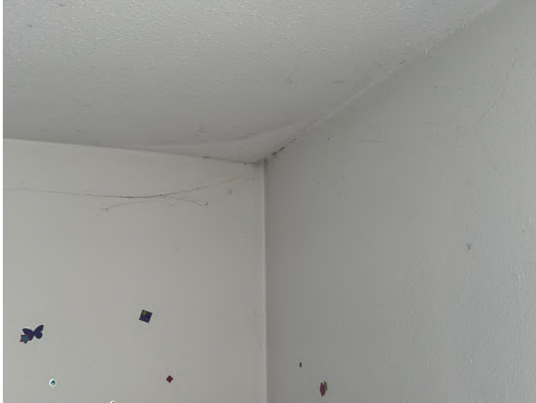
Bild 25 – Schimmel in Außenwand- ecke Kind Nordost EG
