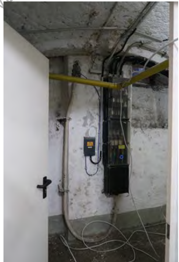
Anschlussraum Massive Feuchtigkeitsschäden
