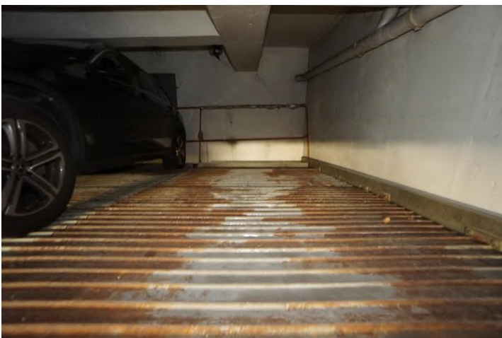
Die Plattformprofile des Kfz-Stellplatz Nr. 19 oben rechts weisen größere Roststellen, verstärkte Korrosion und beginnenden Verschleiß auf.
