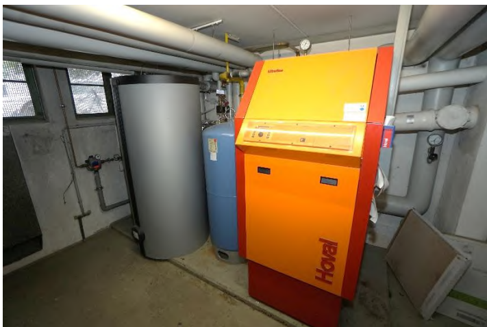
Heizungsraum im Kellergeschoss
