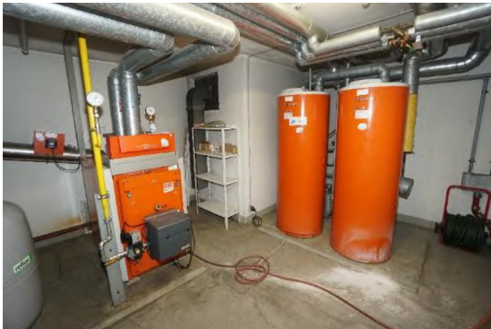
Heizraum im Kellergeschoss
