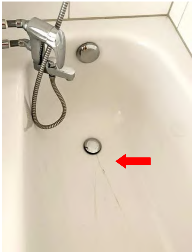
Foto 29: Beschädigung an der Badewanne
