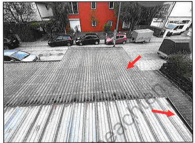
Erneuerungsbedürftige Dachkonstruktion auf dem Anbau; Regenwasser läuft in das Nachbargrundstück
