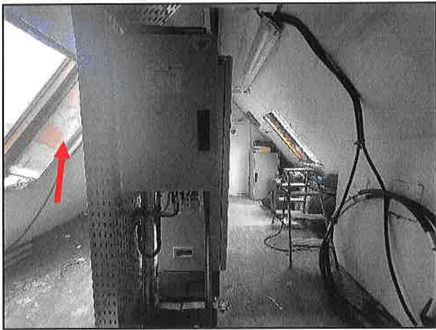
Im Spitzboden befinden sich 2 Mobilfunkmasten; Feuchtigkeitsschäden im Laibungsbereich Fenster
