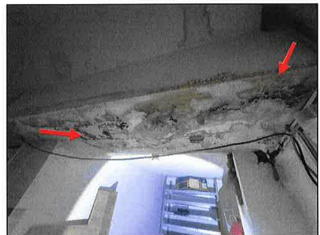
Deutliche Feuchtigkeitsschäden im KG-Bereich
