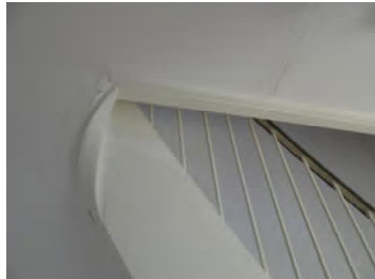
schlechte Putzstruktur Decke Flur EG
