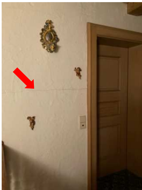
Foto 51: Riss neben Kinderzimmer im Treppenhaus
