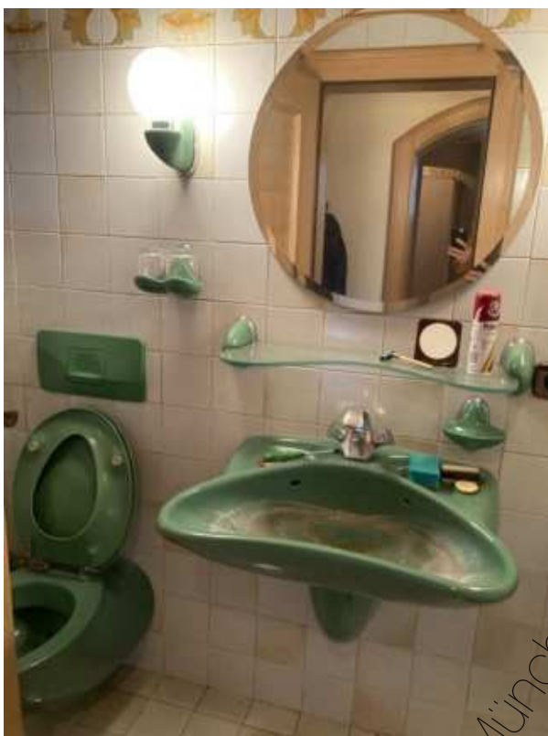
Foto 70: WC im UG
