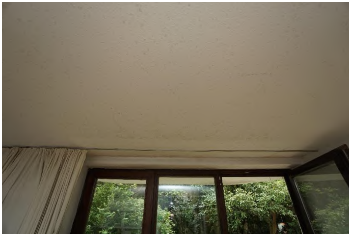
Stockfleckenbildung an der Decke im Wohnzimmer
