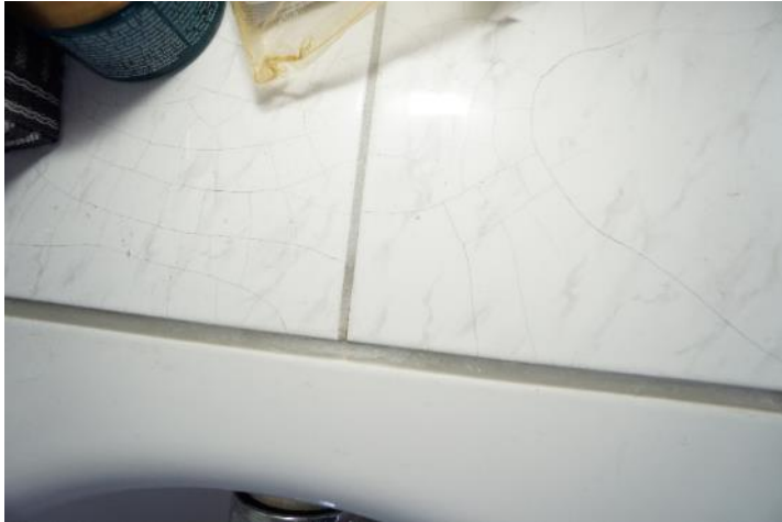
Schadhafte Fliesen im Badewannenbereich
