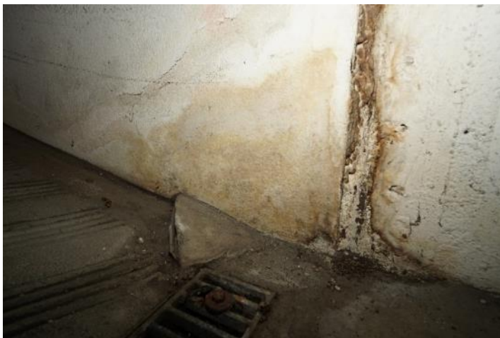
Tiefgarage – Wandverfärbung durch mögliche Korrosionsschäden an Bewehrungsstahl.
