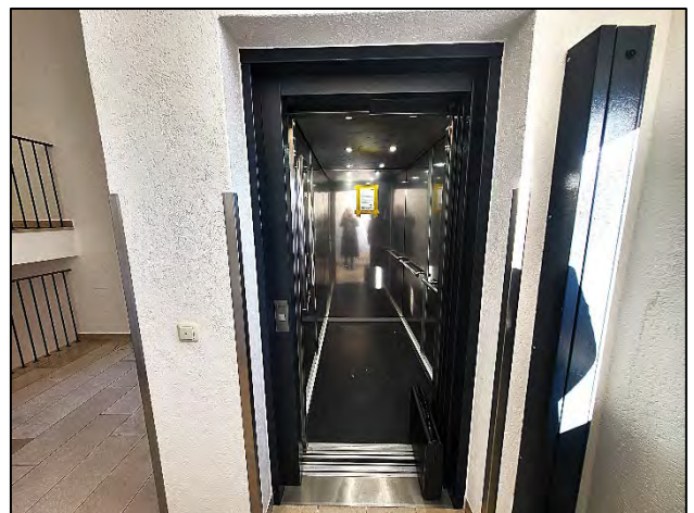
Innenansicht des modernen Aufzugs (Baujahr 2019) der Firma Haushahn; Angabe gemäß für 14 Personen
