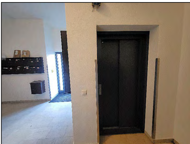
Aufzug im EG; in oberen Geschossen keine Haltestellen auf Geschossebene (nicht behindertengerecht)
