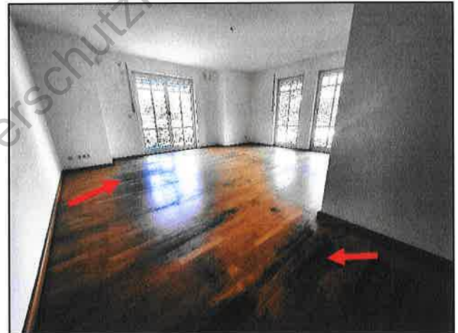
Wohnzimmer Wohnung 5, Blick Richtung Südwestecke; renovierungsbedürftiger Parkettboden
