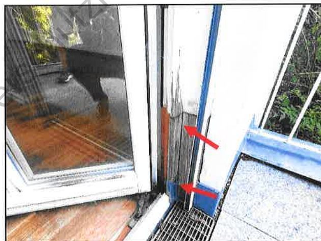
Austauschbedürftige Balkontür im Wohnzimmerbereich
