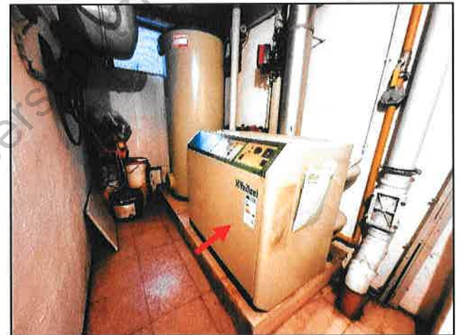
Austauschbedürftige Gaszentralheizung aus dem Jahr 1994
