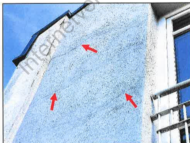
Blick vom Balkon auf die Südwestecke der Fassade; deutliche Rissbildungen erkennbar
