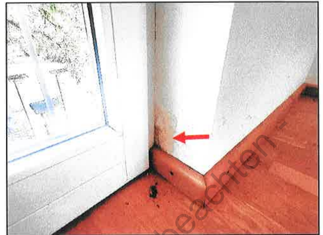
Feuchtigkeitsschäden auch im Sockelbereich
