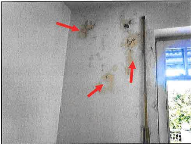
Feuchtigkeitsschäden in der Südwestecke des Wohnzimmers der Wohnung Nr. 5
