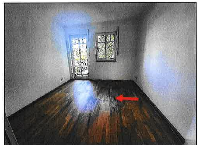
Kinderzimmer, Blick Richtung Balkon; auch hier muss der Parkettboden renoviert werden
