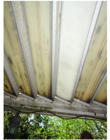
Terrassen-Überdachung mit Hagelschaden
