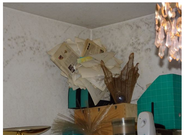
Alter Wasserschaden an Wänden und Decke
