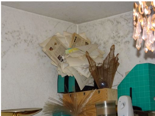
Alter Wasserschaden an Wänden und Decke
