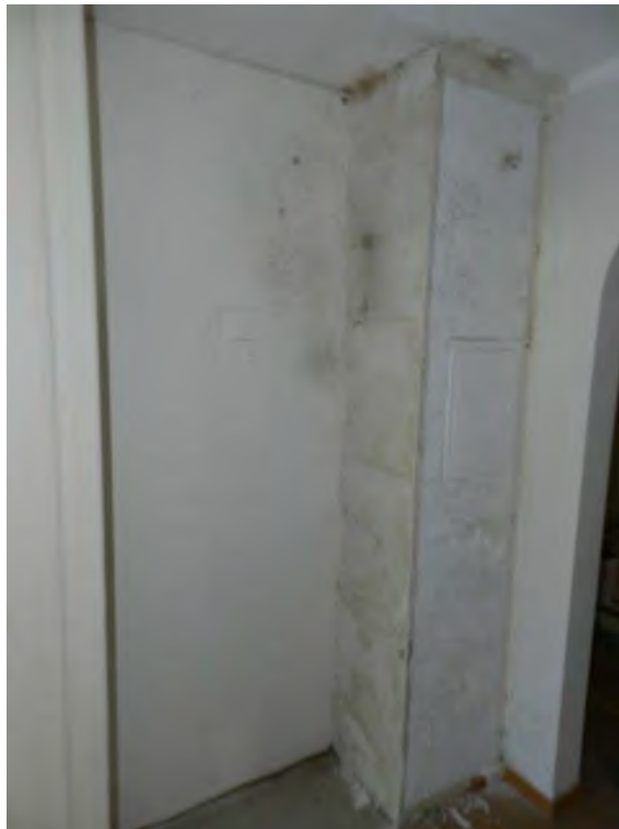
Whg. Nr. 11, Feuchtigkeitsschaden am Kamin
