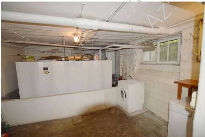
Heizungskeller mit Öltank
