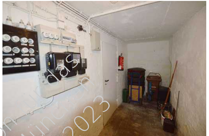
Kellerflur mit Stromverteilern
