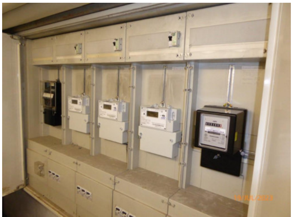
Blick in den Elektro-Verteilerkasten im Kellergeschoss
