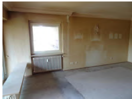
erhebliche Abnutzungen und Verfärbungen
