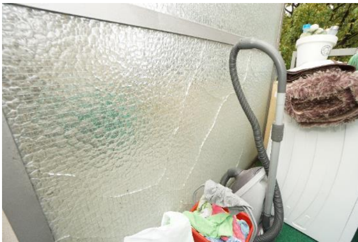
Glasscheibe der Trennwand zum Nachbarn ist gerissen
