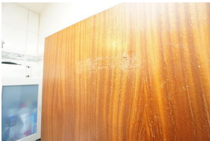
Innentür (Bad) mit Kratzern und Beschädigungen
