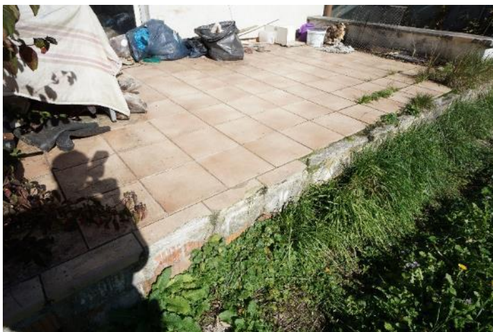
Schäden an der Terrasse
