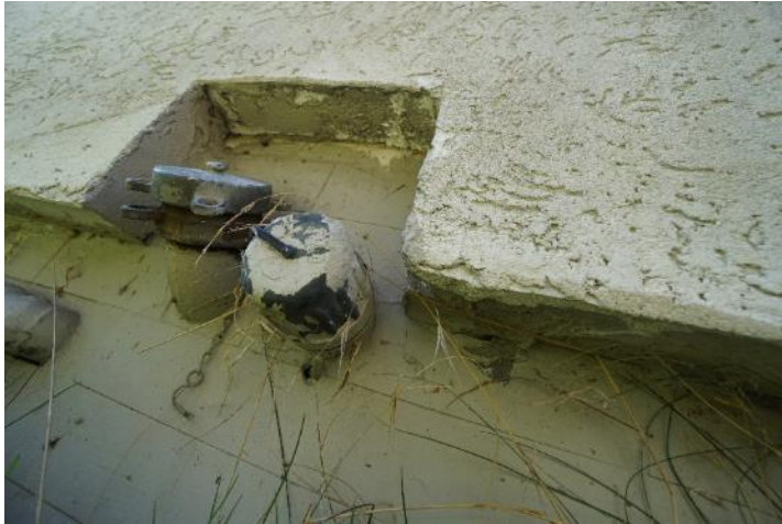
Anschluss zum Öltank
