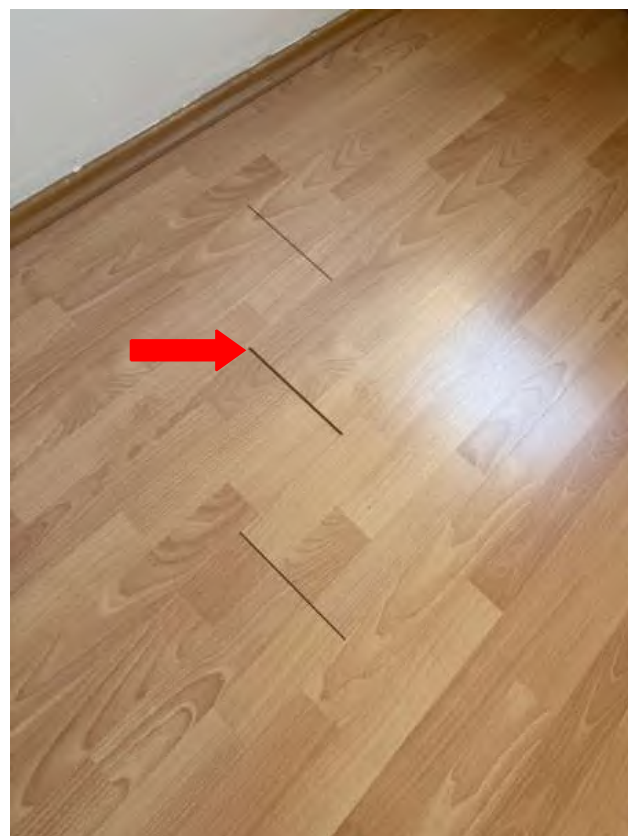
Foto 20: Fugen im Laminat
