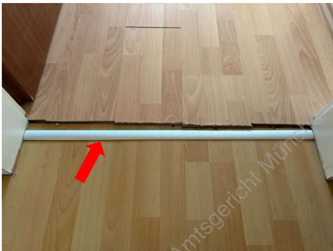
Foto 24: Mangel bei der Verlegung des Laminats
