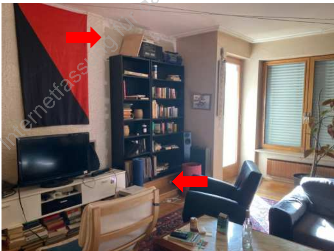
Foto 35: eingezogene Wand im Wohnzimmer, Höhenversatz
