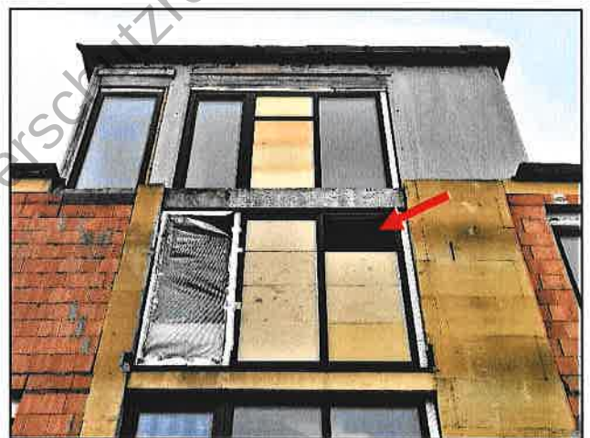
Im Obergeschoss fehlen Scheiben im Treppenhausebereich
