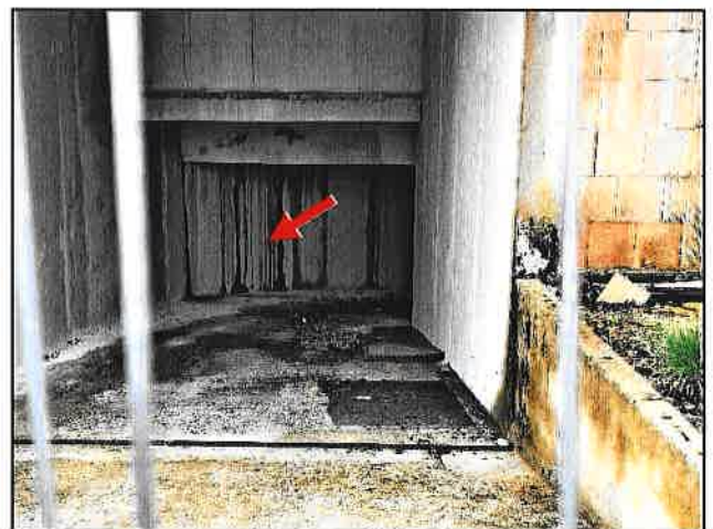
Sichtbarer Wassereintritt mit Schlierenbildung an den Stahlbetonwänden im Rampenbereich
