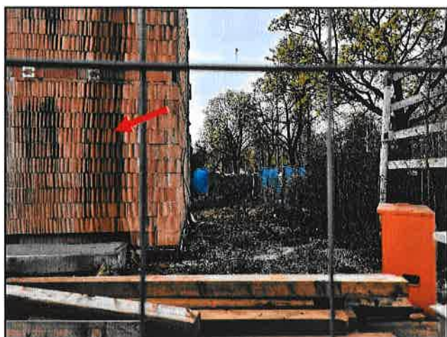
Dunkle Fleckenbildung und Wasserschlieren mit Feuchtigkeitsschäden im EG (exemplarisch)
