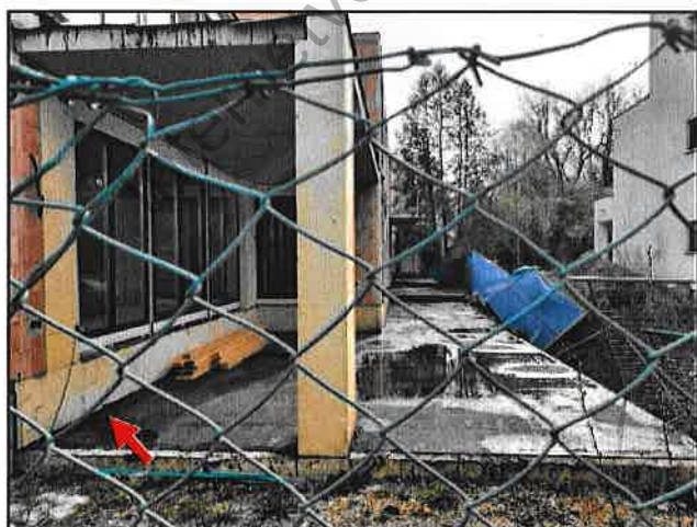
Terrasse im Erdgeschoss; Feuchtigkeitsschäden im Sockelbereich erkennbar
