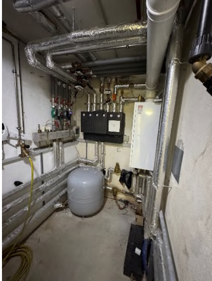
Bild 7 und Bild 8 – Heizungsraum
