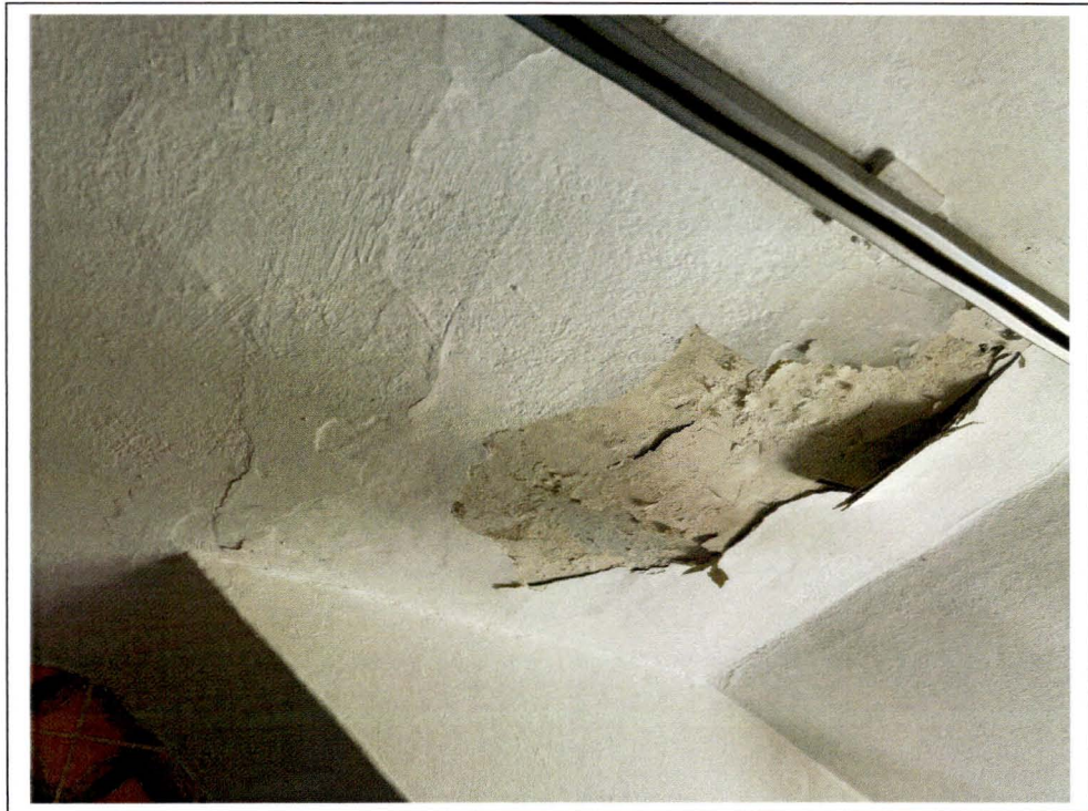
Foto 19: Nässeschaden an einem Dachflächenfenster
