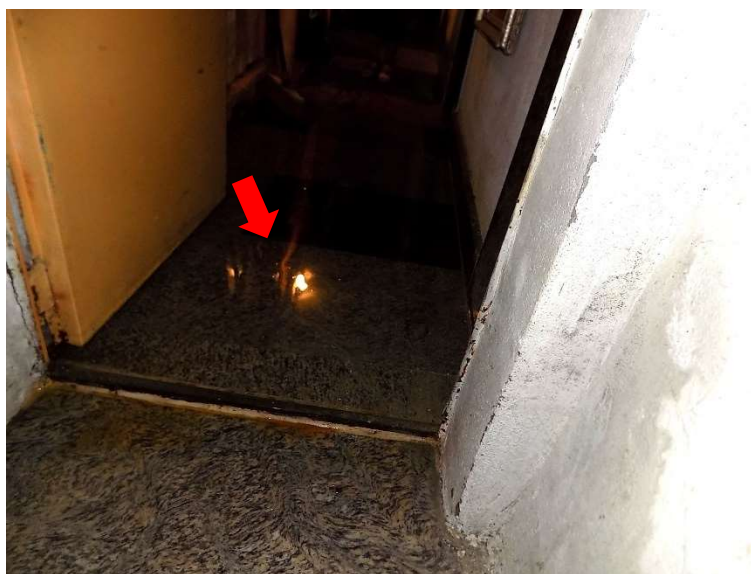
KG: Pfeil, stehendes Wasser
