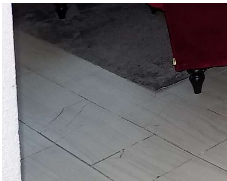
OG: Detail: Risse in den Bodenfliesen
