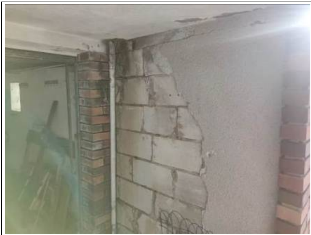
Blick auf Putzschäden im Bereich der Garage
