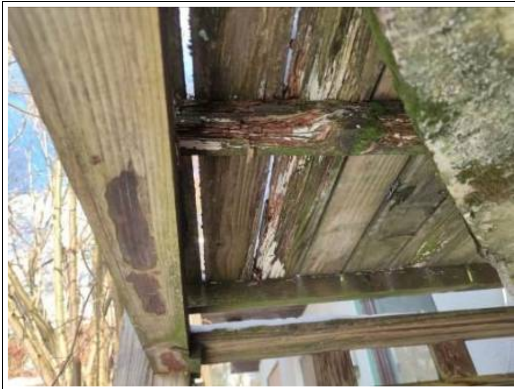
Blick auf durchgefaulte Bretterböden beim Zugang zum Balkon über der Garage
