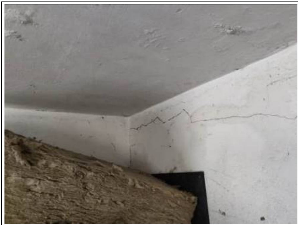
Blick auf Gebäuderisse in der Garage
