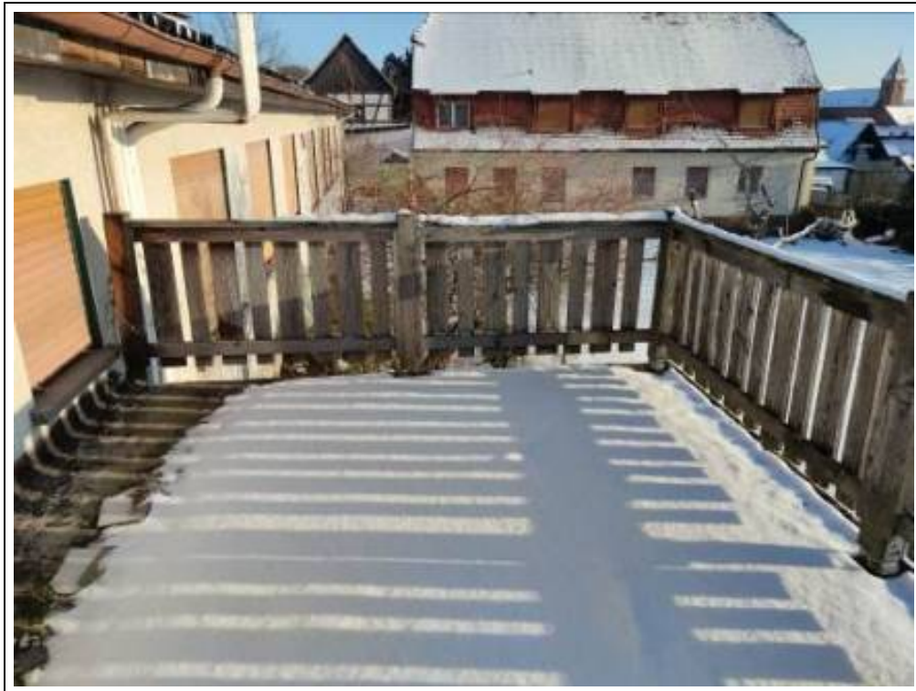
Blick auf das als Balkon genutzte Flachdach der Garage (ohne Abdichtung)
