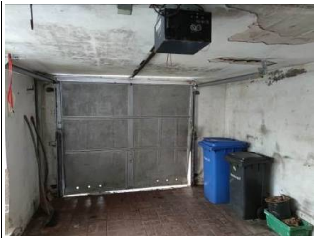
Blick in die Garage mit elektrischem Klappschwingtor
