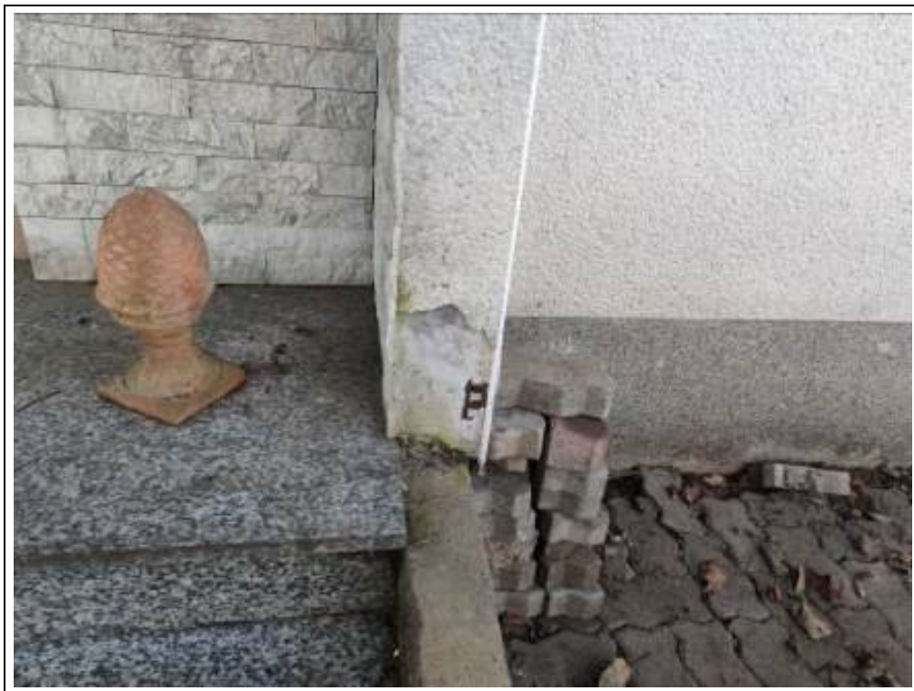
Blick auf Putzschäden im Eingangsbereich zur linken Wohnung
