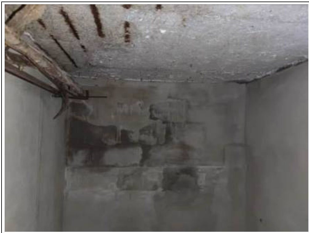
Blick in den Abstellraum in der Garage mit Schäden an der Bewehrung
