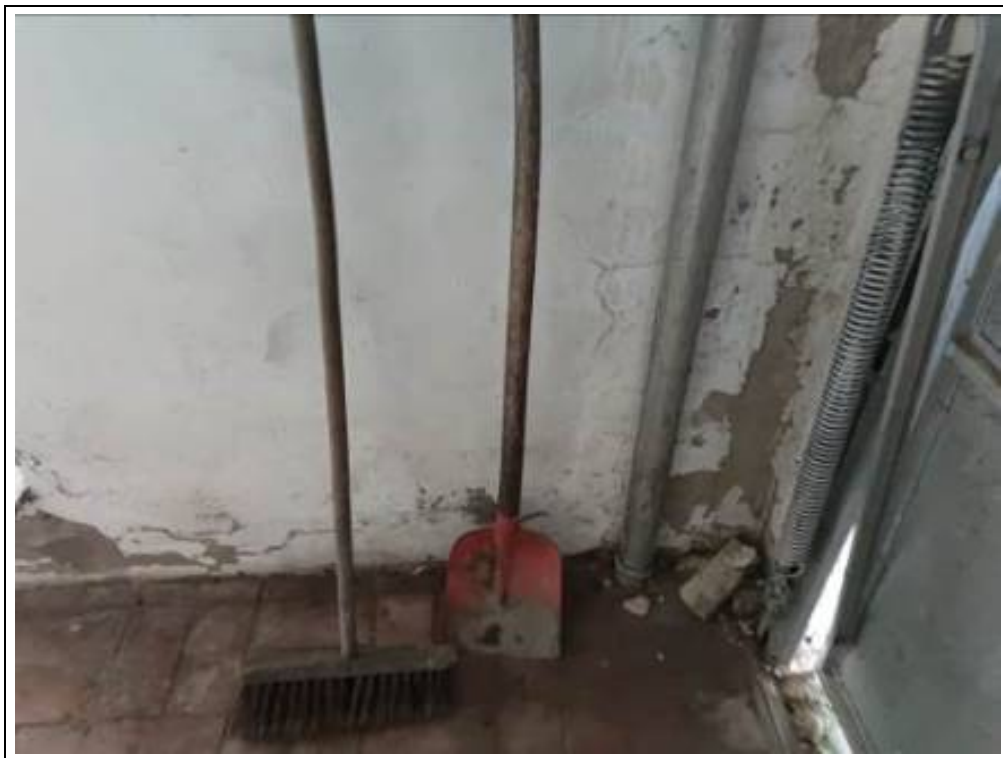
Blick auf Putzschäden an der Wand
