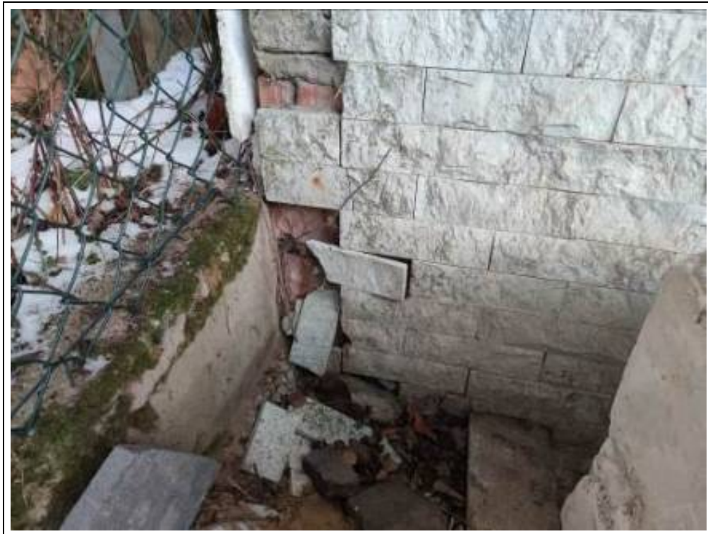
Blick auf Schäden an der Natursteinverkleidung der Außenwand
