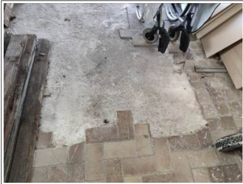
Blick auf fehlende Fliesen in der Garage
