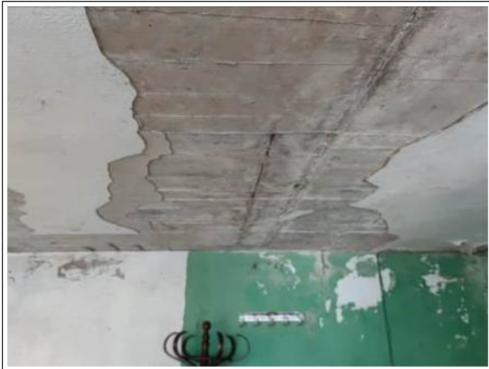
Blick auf Putzschäden an der Decke
