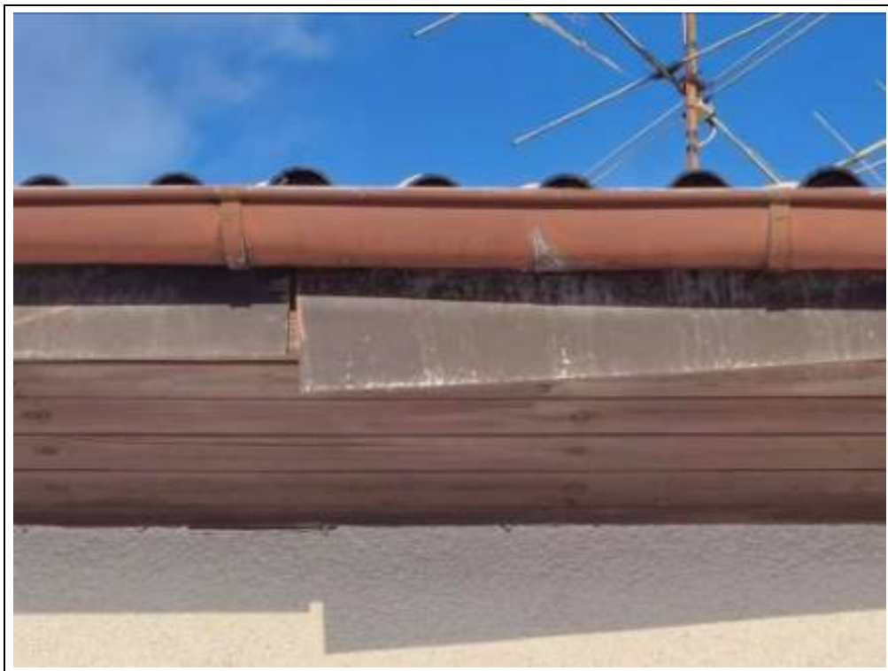
Blick auf Schäden an der Traufverkleidung
