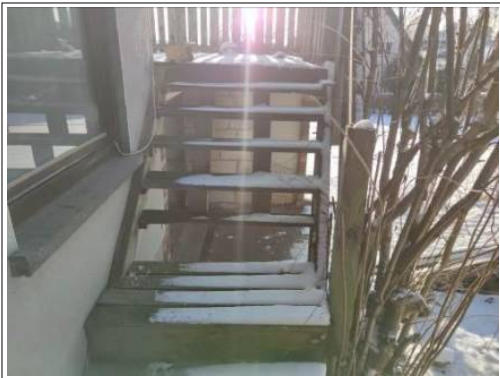
Blick auf die marode Holztreppe als Zugang zum Balkon über der Garage
