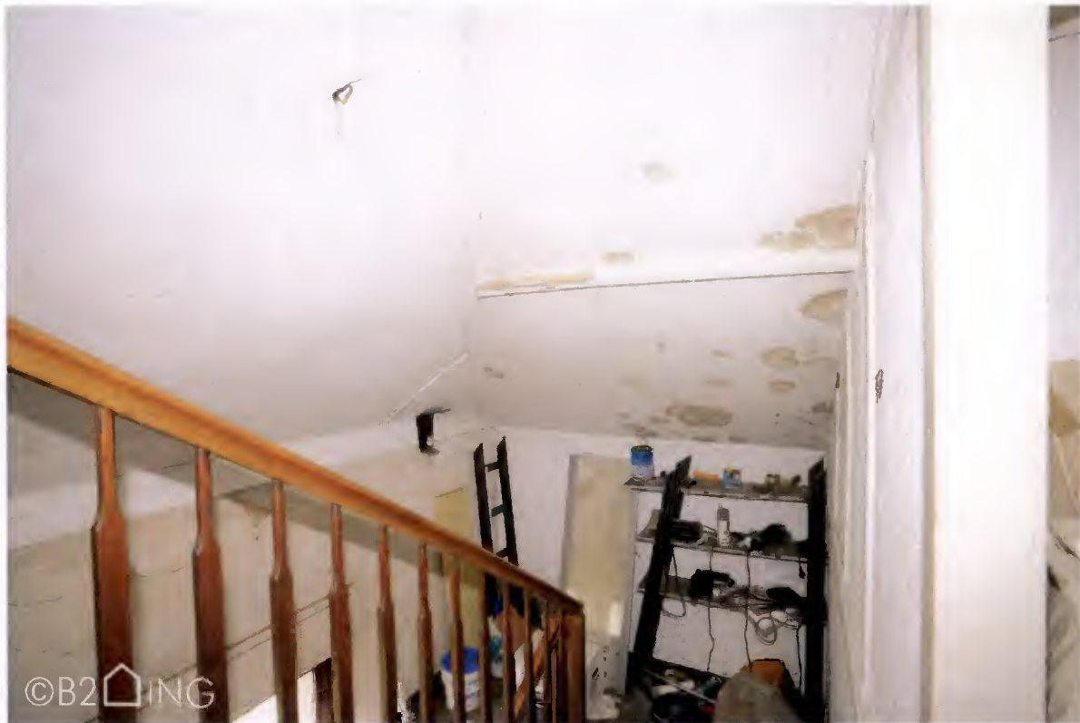
Abb. 17: Treppenhaus, Wasserschaden Dach
