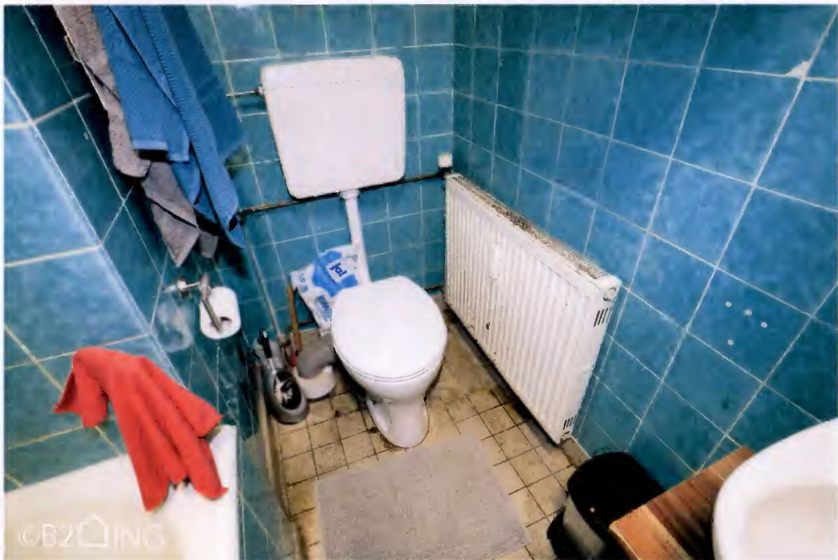
Abb. 21: Bad EG, WC (undicht)
