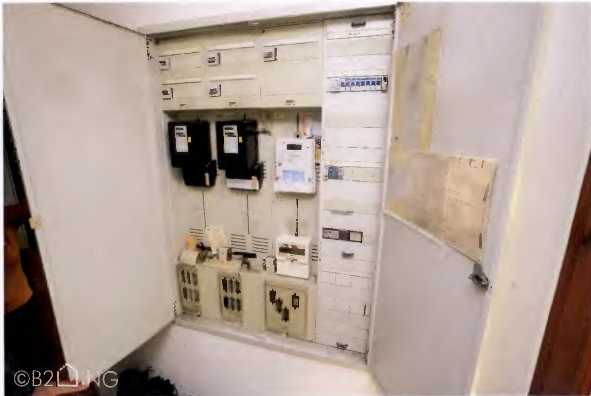
Abb. 30: Elektrounterverteilung Treppenhaus EG
