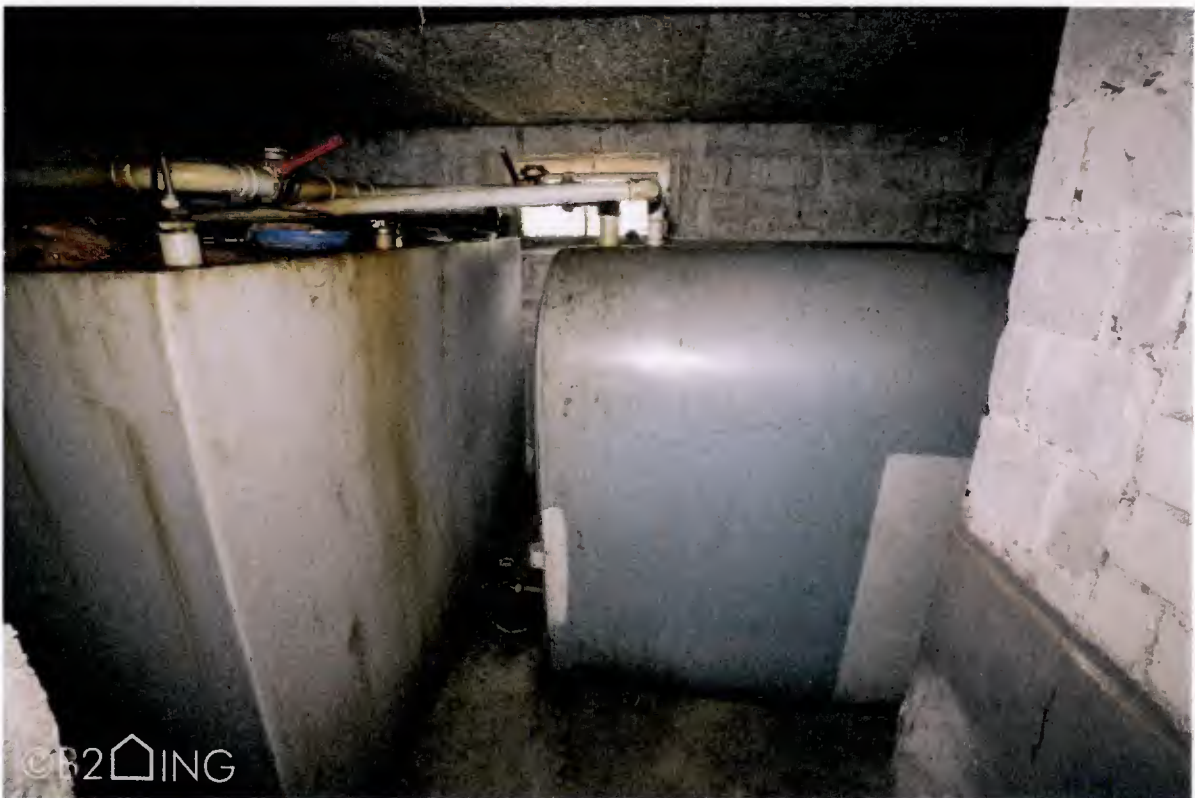
Abb. 25: Tankraum unter der Terrasse EG
