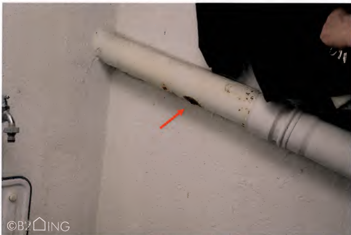
Abb. 33: schadhafte Abwasserleitung in der Waschküche
