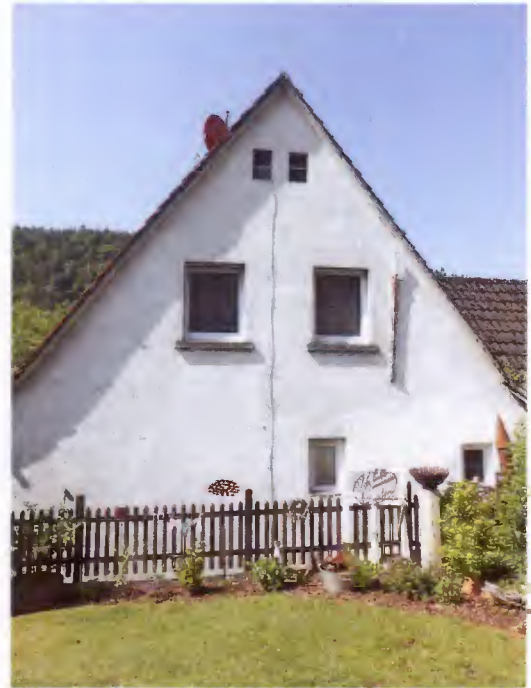
Außenfassade teilweise Anstrich erneuern
