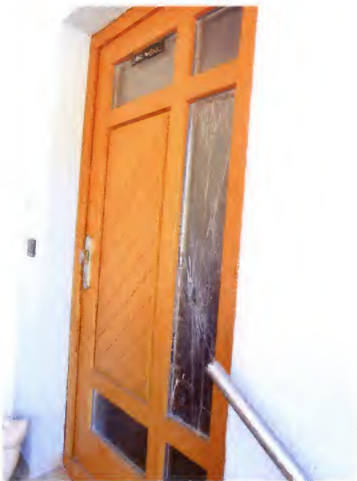
Glasscheibe von Haustüre Seitenteil beschädigt
