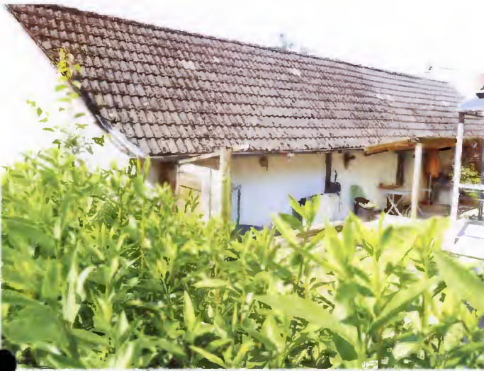
Ziegel – Nebengebäude in absehbarer Zeit erneuern
