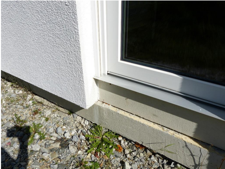
Einfamilienhaus, Teilansicht Fenstertür im Erdgeschoss unvollständig
