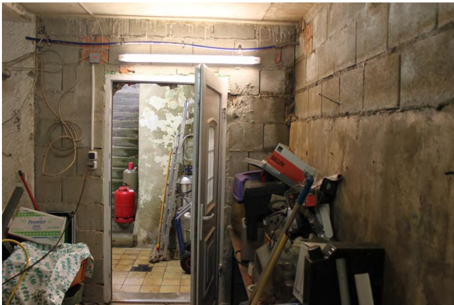
Bild 18: Zustand der ostseitigen Abstellräume
