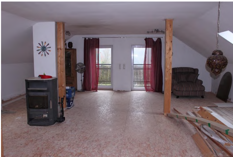
Bild 6: Zustand der Dachgeschosswohnung W4
