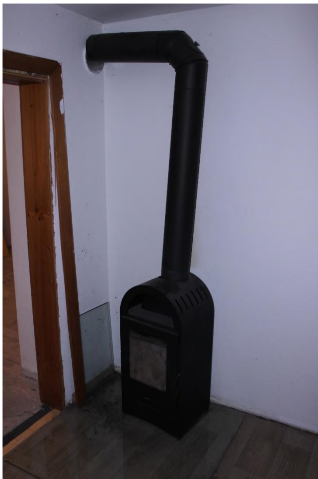
Bild 10: Beheizungsmöglichkeit der Wohnung W2
