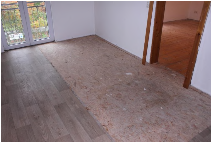
Bild 9: Zustand der Wohnung W2 im Obergeschoss
