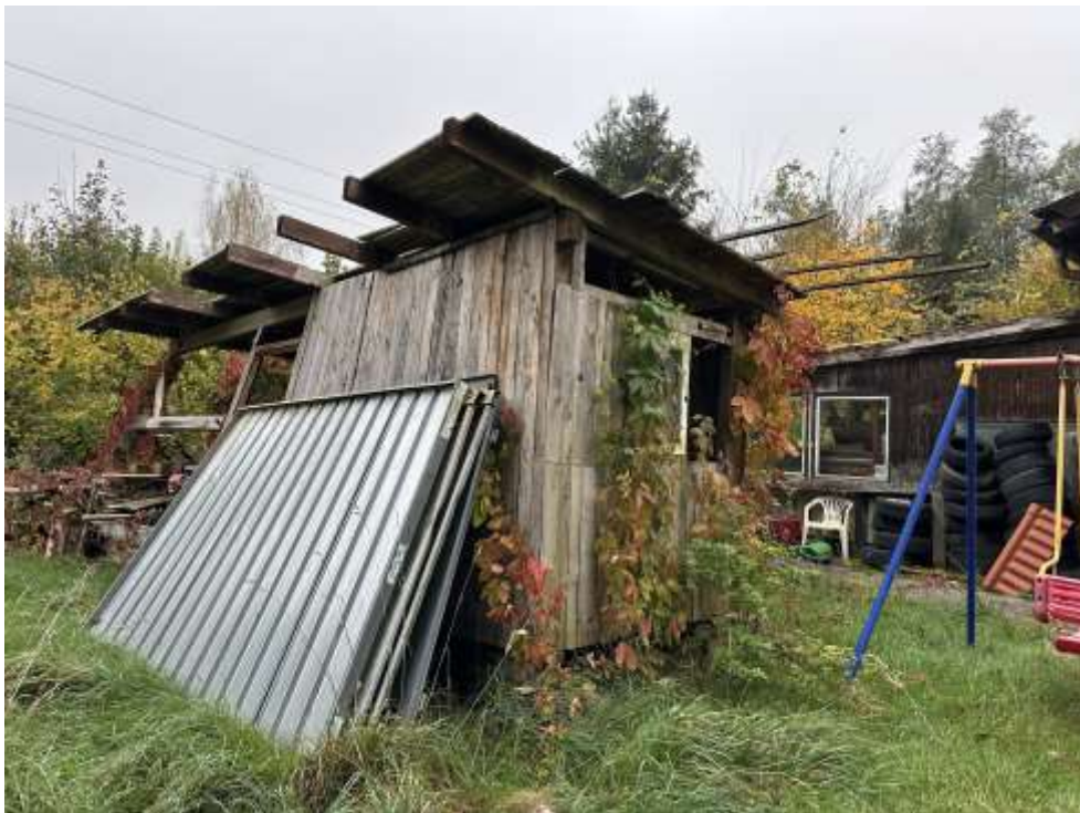
Bild 6: verfallene Überdachung auf Flurnummer 93
