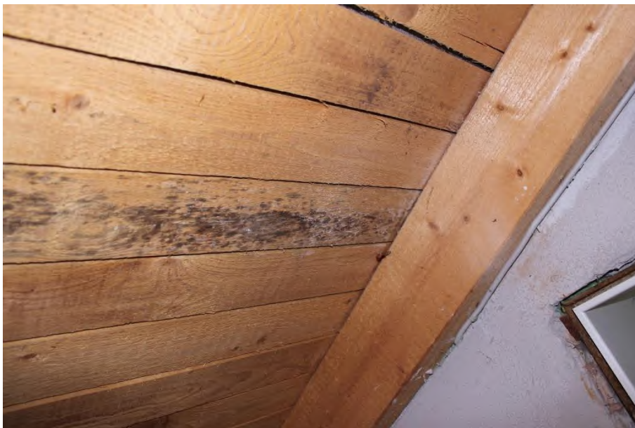
Bild 14: partieller Schimmelbefall der Holzteile im Dachraum über der Garage
