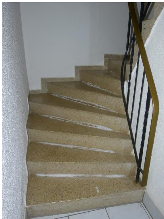
Gebäude 1: Zweifamilienhaus, Innenaufnahme Treppe vom Erd- zum Kellergeschoss mit Salpeterausblühungen
