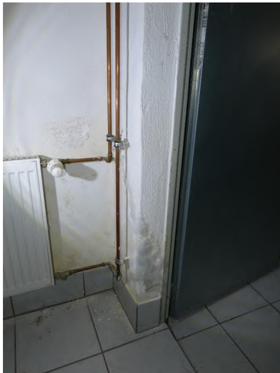
Gebäude 1: Zweifamilienhaus, Innenaufnahme Putzschäden (Salpeterausblühungen) im Kellergeschoss
