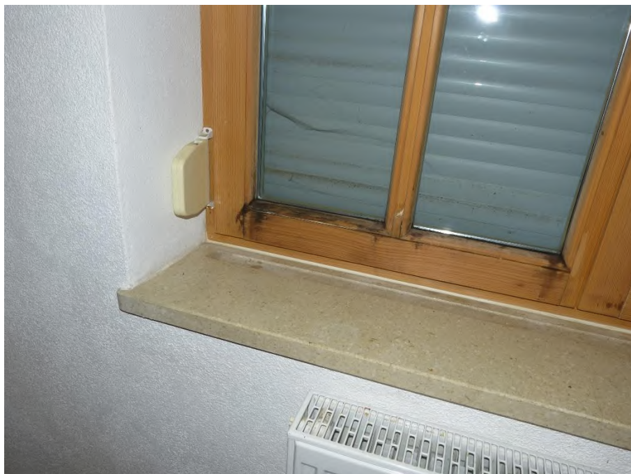
Gebäude 1: Zweifamilienhaus, Innenaufnahme Fenster im Erdgeschoss mit Schimmelbefall
