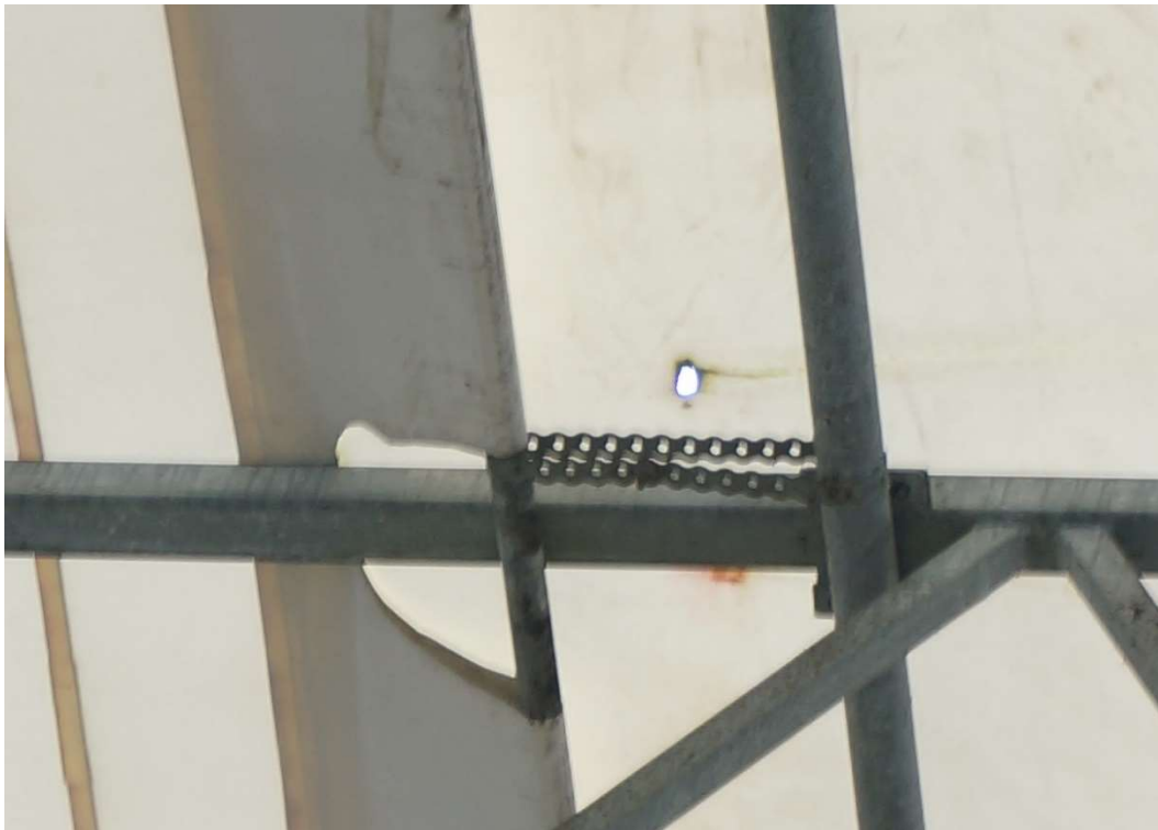
Bild 36: Ein Loch in der Dachplane im Liegebereich der Milchkühe
