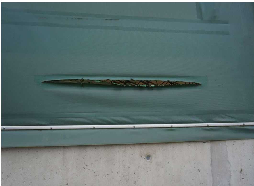
Bild 30: Ein weiterer, deutlicher Riss in der Giebelwandplane
